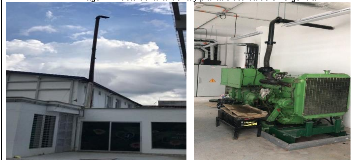
imagen 4. Ducto de lavandería y planta eléctrica de emergencia
